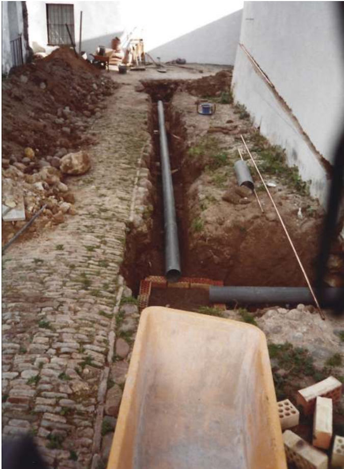
Instalación de saneamiento de la capilla de San Gregorio realizada durante las obras del año 2000-2001. Se aprecia la cuesta de entrada al Corral
